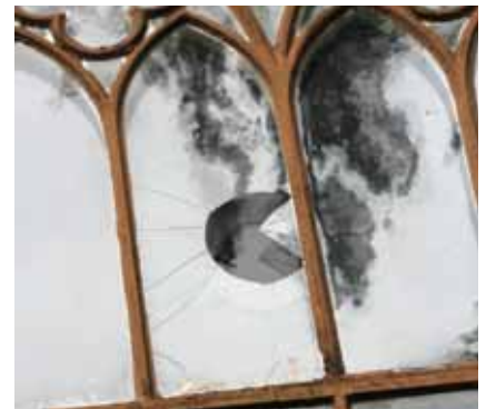
Nykirke og Snarum: Her er det behov for utskifting og reparasjon av enkelte vinduer.
