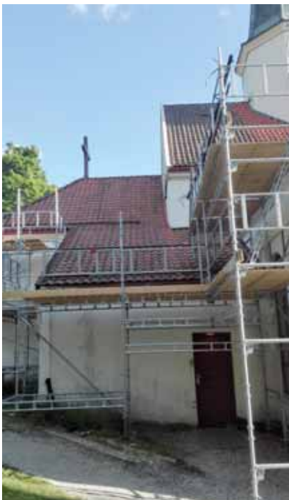
Heggen kirke: Råteskader på loft er reparert, og i høst startes det med takreparasjoner. Det vil dermed stå stillaser mor nord/øst en periode fremover.
