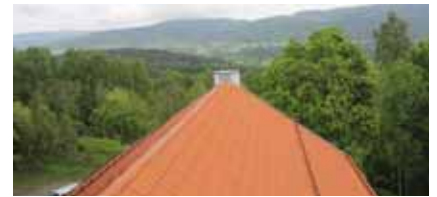
Nykirke: Takstein som er løse skal festes.
