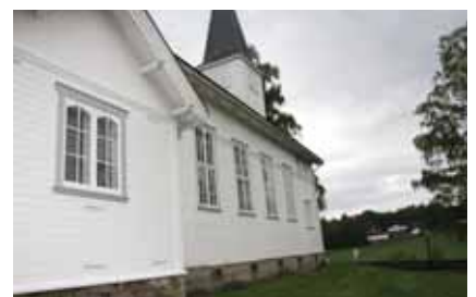
Rud kirke: Deler av den ene vegg var råttne og er nå skiftet ut. Det samme vil skje ved inngangspartiet, hvor det er flere råttne områder.
