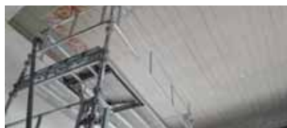
Heggen kirke: Taket inne i nordskipet vaskes og veggene males. Utover høsten vil benkene bli satt inn igjen, rehabiliterte og med nytt varmesystem påmontert.
