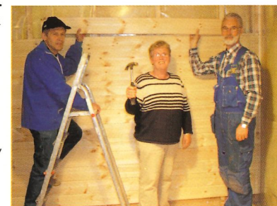
Leif Grøteide, Bjørg Hellesøy og Ingmar Ljones i arbeid med innreiinga av det nye tilbygget.
