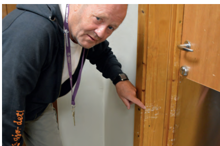
Nedslitte karmar og dører trengte hjelp
