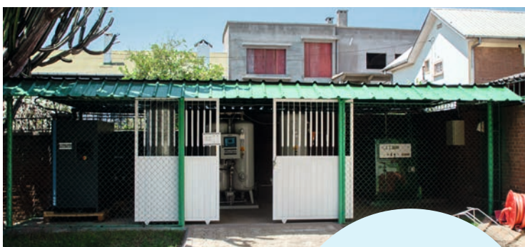
Oksyngeneratoren fra Belgia ble tatt i bruk med en gang.
