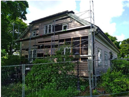
Kirkestua-foto 27 juli 2020 råteskader på flere vegger må utbedres
