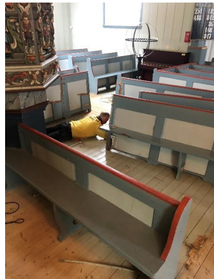
Kirketjener Bent, i full sving med arbeidet med å fjerne benker og ovner i Gjerdrum
