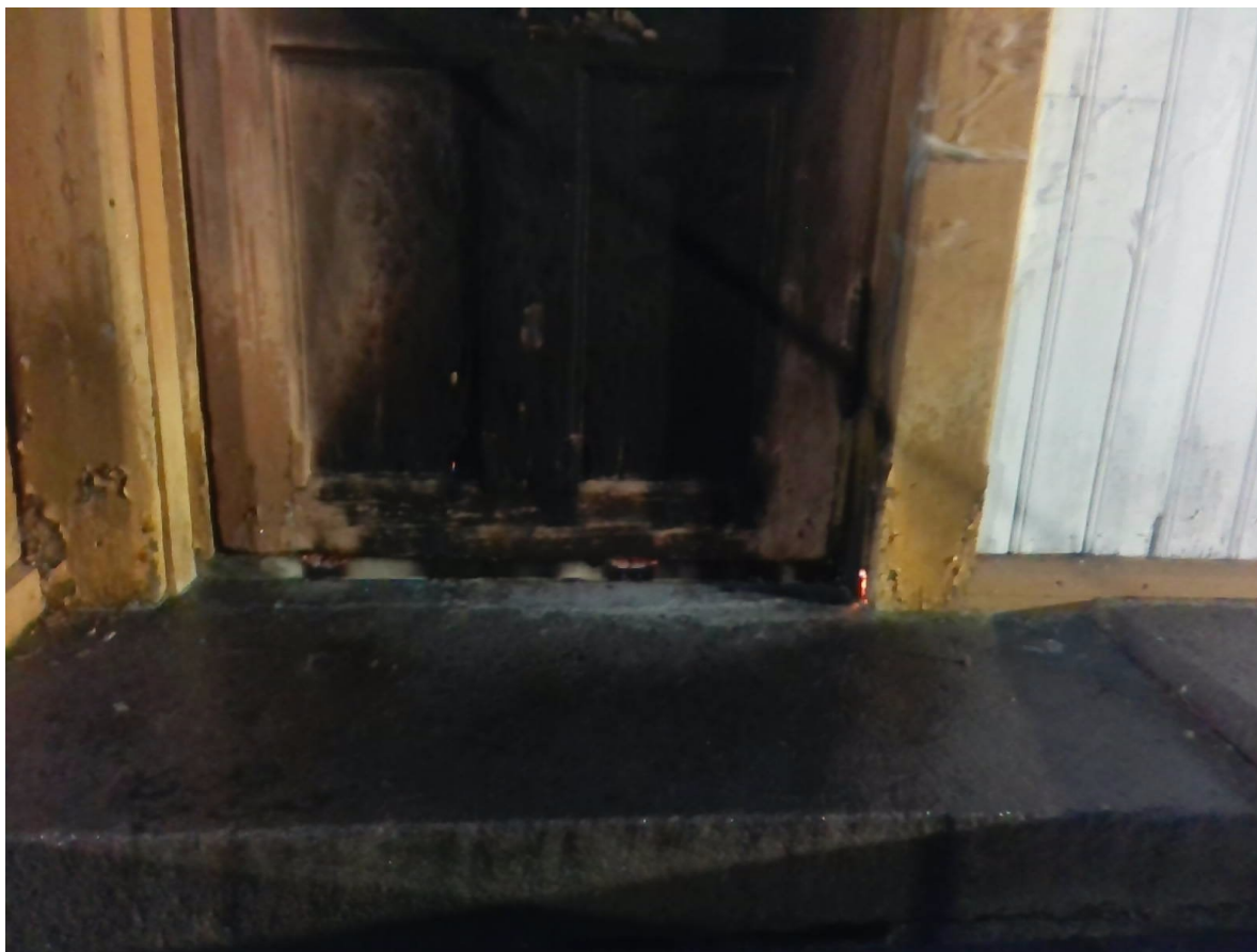
Figur 2: Døren etter at slokking har startet, klokken 03.19
