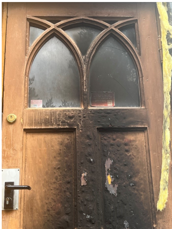
Figur5: Brent dør, som viser en omvendt brannvifte. Typisk tegn for bruk av brennbar væske
