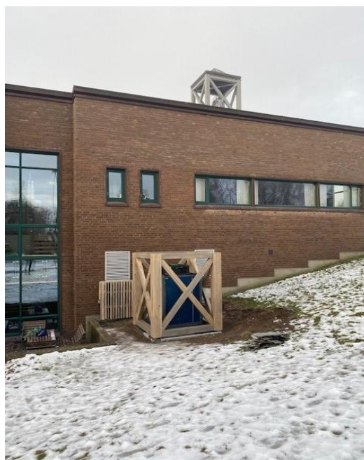
Varmepumpe Berg arb. kirke, med kopi av tårn under oppføring.
