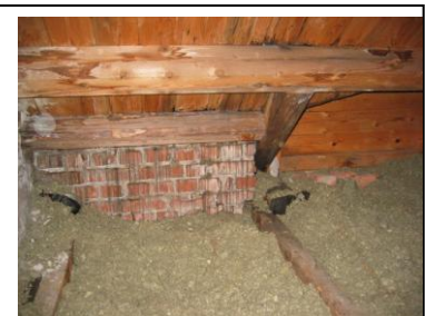
Vannlekkasje ved pipa
