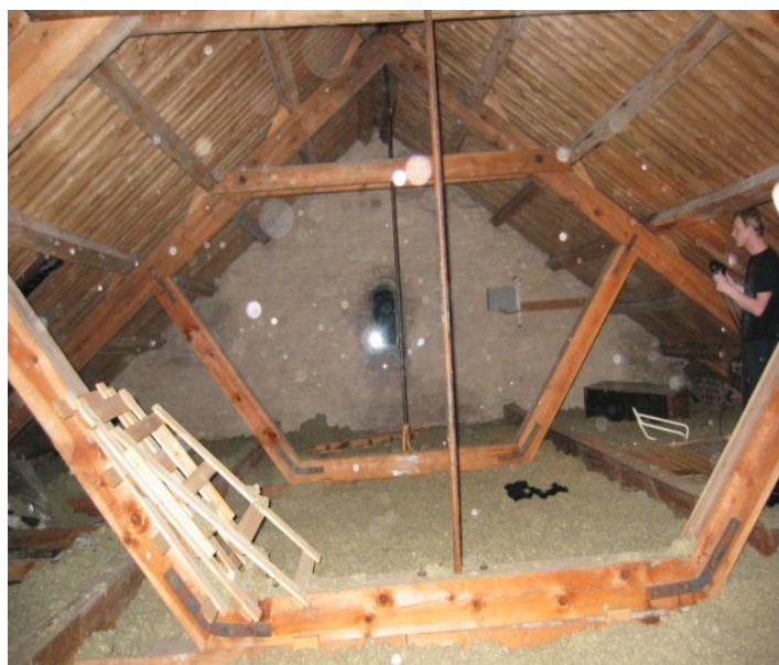
Taket er i hovedsak tett og fint, men har enkelte svakheter. Viser for øvrig til tilstandsrapporten for 2004.
