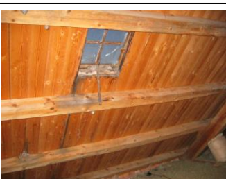
Vannlekkasje ved begge takvinduene.
