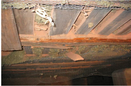
Råte og fuktskader har pågått i flere tiår.
