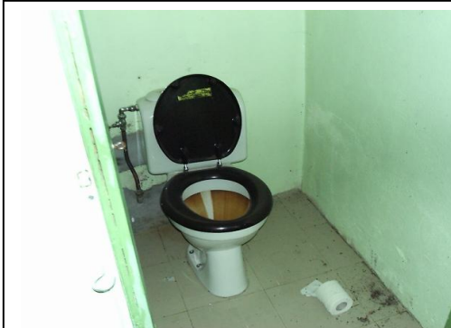
Toalettanlegget i kirken kan ikke anbefales.
