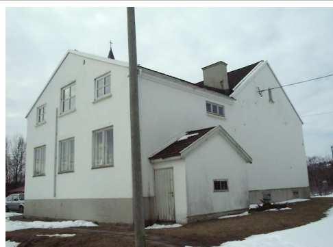
Nytt tilbygg?: Hc/wc og nedgang til kjelleren. Rullestolinnang mangler !
