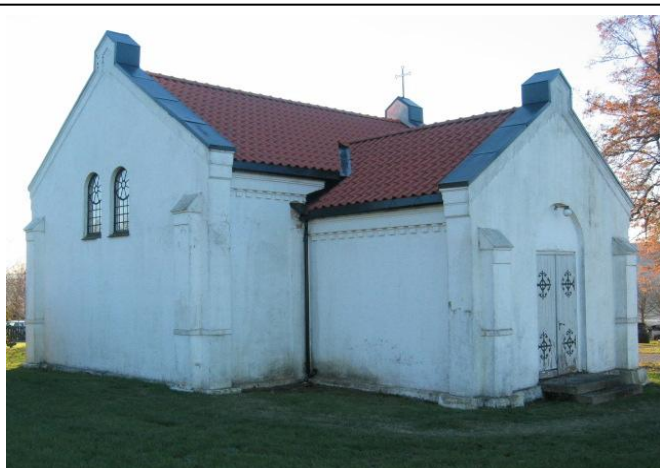
Utvendig trenger kapellet en opp-pussing
