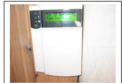
Alarm er installert i kapellet
