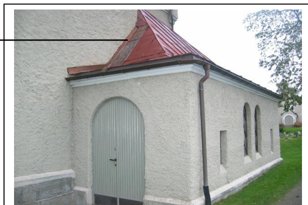
Sakristitakene er dårlige. Vanninnsig i fjor. Nytt tak må legges inn i handlingsprogrammet.
