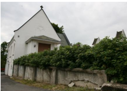
Den gamle forstøtningsmuren ved Frogner kapell hadde utspilt sin rolle.
