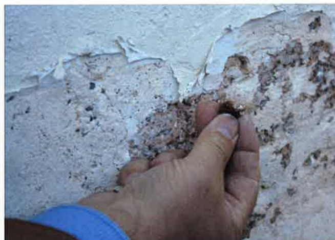
Dyrehår ble i gamle dager lagt inn for at pussen skulle herde bedre og unngå sprekkdannelser.
