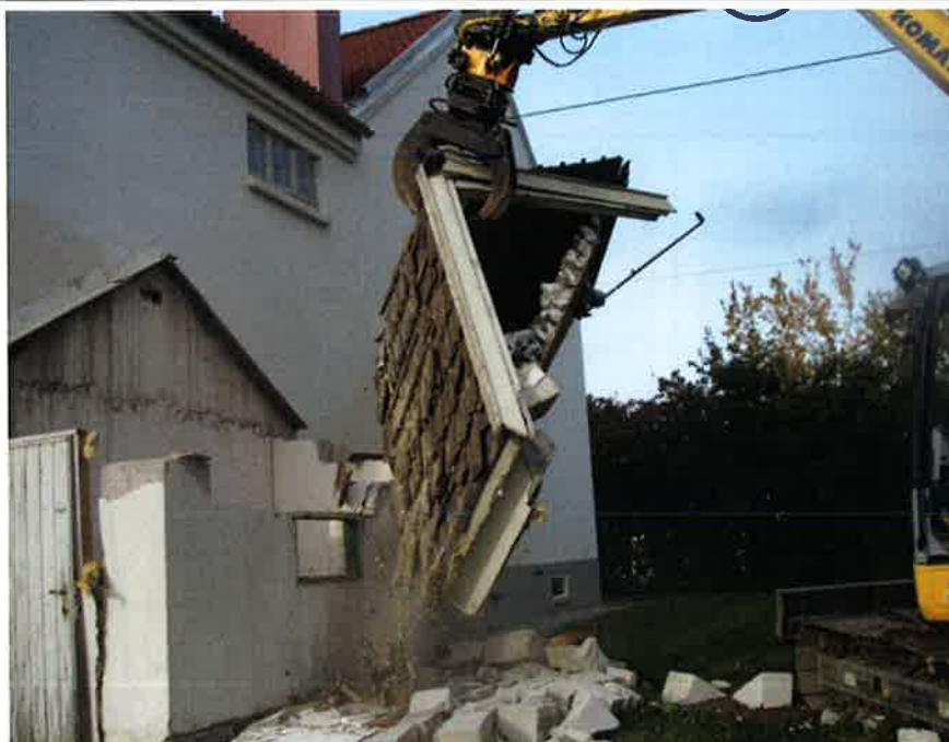
Her rives den gamle trappeoppgangen på baksiden og et nytt tilbygg er i gang. Foto Sverre Løvåsdal.
