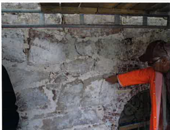
Bilde 22 Selningsprekker registreres.
