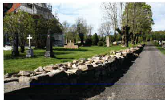
denne muren er falleferdig og må bygges om
