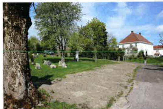
Det råtne gjerdet fjernet og ny steinmur vurderes.....
