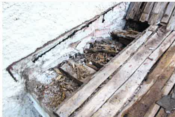
Vi hadde forventet råteskader langsmed veggen
