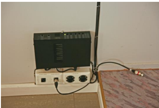
Høytaler- og forsterkeranleggene ble oppgradert i kirkene i 2013. Tre av kirkene hadde for dårlig teleslyngeanlegg. Dette er nå rettet opp.
