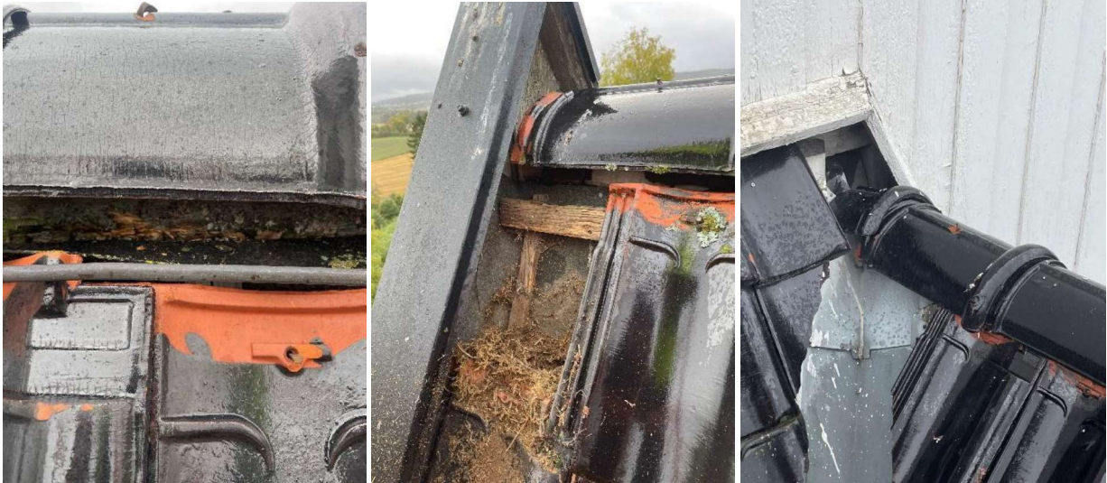
Takstein er bl.a. ikke lagt med tilstrekkelig overlapp og taksteinen gir ikke tilstrekkelig feste til undertaket.
