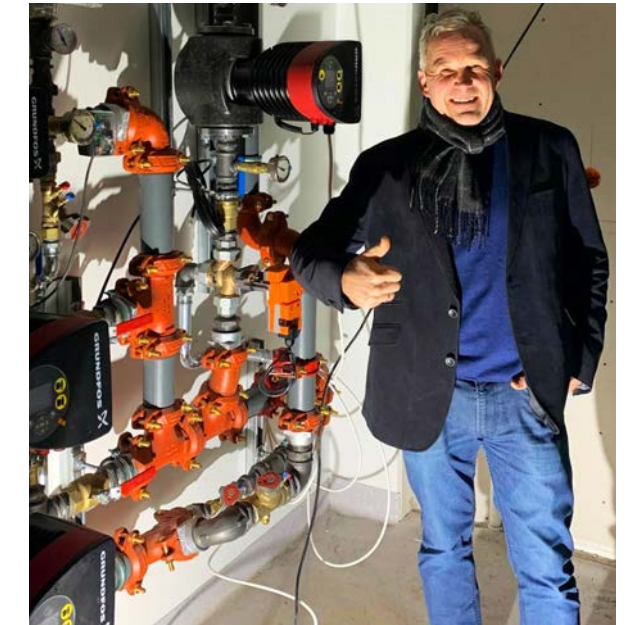
Bygg- og eiendomssjef André Eidem Selli er fornøyd med den nye tekniske og miljømessige oppgraderingen av Nordberg kirke.
