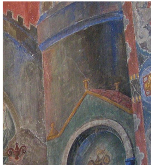
Figur 19: Utsnitt av bildet til venstre. Flere av sprekkenes har allerede vært der, da bildet ble tatt, mens det kan se ut til at enkelte sprekker har kommet til siden da: Se området merket med stiplet linje sammenlignet med samme utsnitt i Figur 15. Foto: Oddbjørn Sørmoen, Riksantikvaren, Riksantikvarens arkiver.
