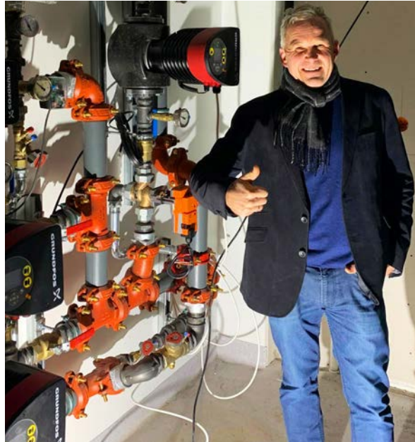
Bygg- og eiendomssjef André Eidem Selli er fornøyd med den nye tekniske og miljømessige oppgraderingen av Nordberg kirke.
