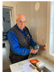
Olav Dalby var ansvarlig for det elektriske opplegget. Foto: Karsten Nyborg
