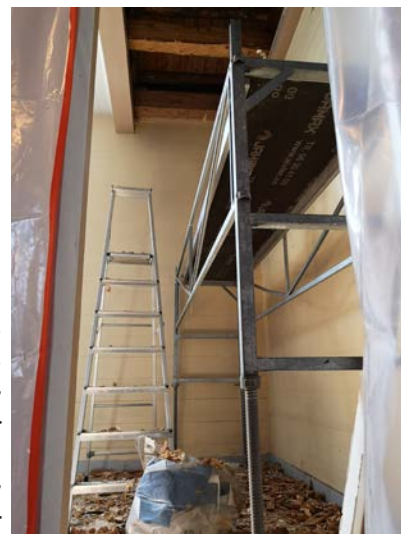
Det kan komme overraskingar når gamle konstruksjonar skal endrast. Foto: Hanne Schnitler
