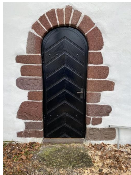
Ny dør godkjent som rømningsvei Sem kirke. Foto: Tønsberg kirkelige fellesråd
