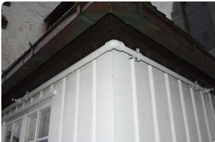
Nytt sprinkleranlegg i Byneset kirke. Foto: Yngvil Bjellaanes
