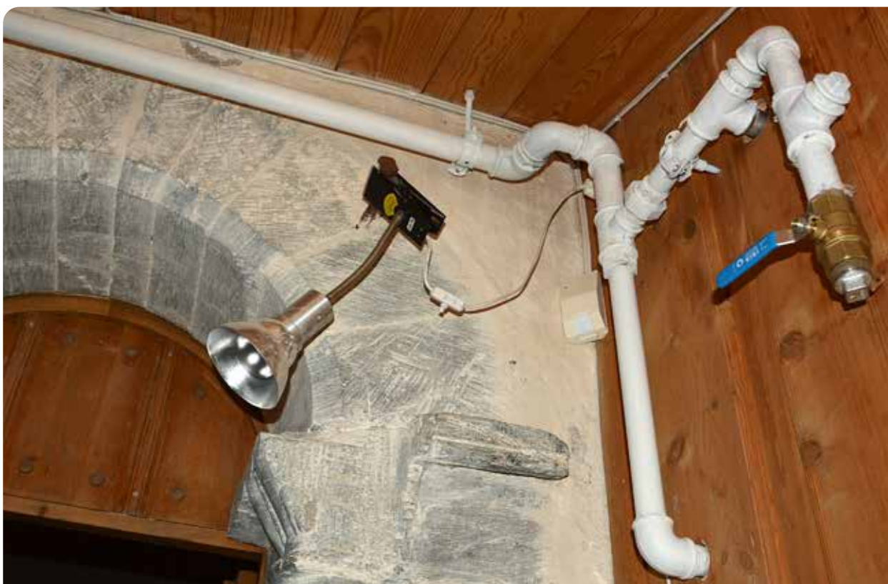
KfiT fikk tilskudd av Riksantikvaren til å installere automatisk slukke-anlegg i Byneset kirke. Valget falt på et konvensjonelt sprinkelanlegg for alle rommene i kirken. Foto: Yngvil Bjellaanes
